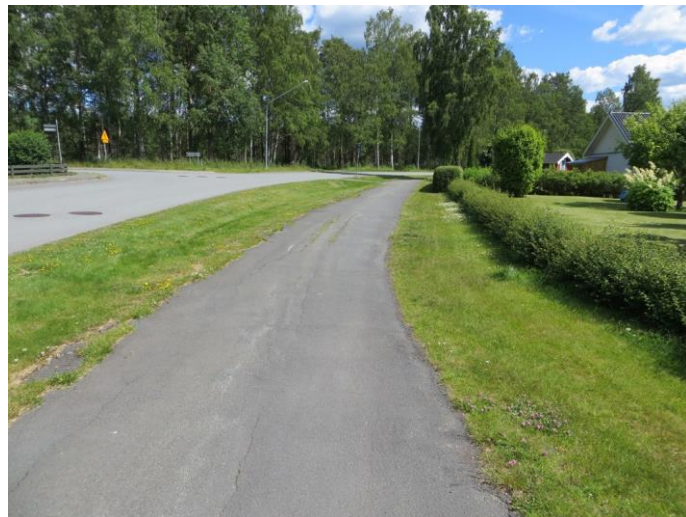
15. Gång- och cykelväg längs Bredestadsvägen. En av de vägar som är i behov av underhåll: ojämnheter, ogräs och sprickor i asfalten samt linjemarkering som behöver förtydligas.
