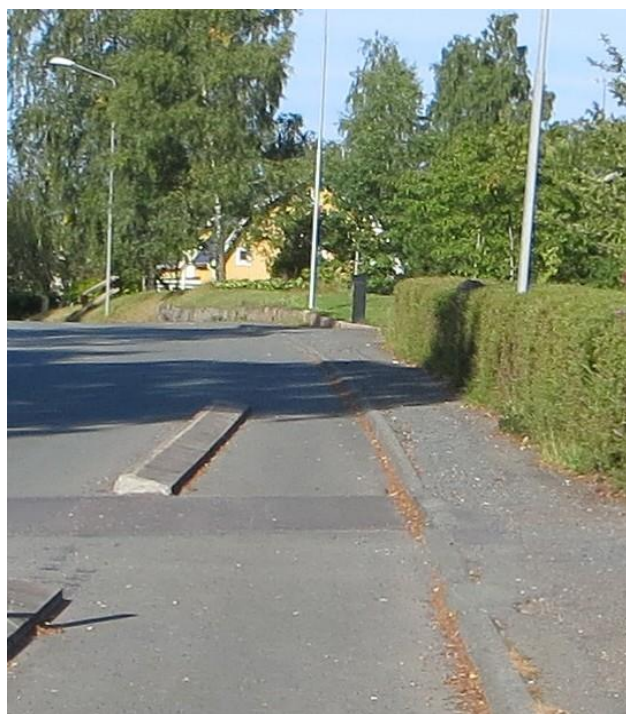
Cykelbana som plötsligt upphör på Jönköpingsvägen i Aneby tätort
